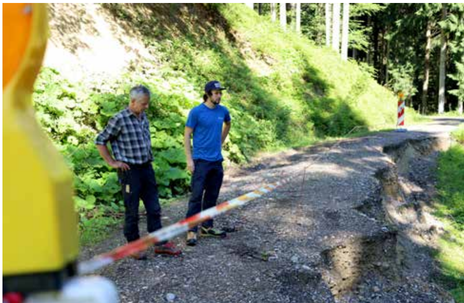
Rainer Kiehstaller (links) von der örtlichen Wegebaugemeinschaft und Förster Sebastian Seifert (rechts) begutachten den Schaden an einem Forstweg bei Wengen; Foto: Anna Munkler, AELF Kempten
